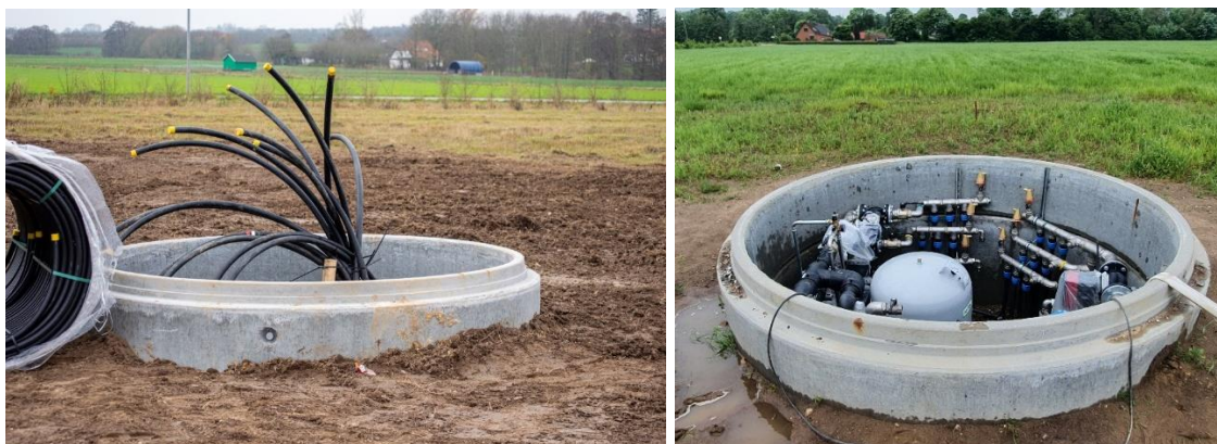
Figur 21 Samlebrønden under etablering (venstre) og efter installation af manifold til styring og regulering af køle- og varmforsyningen.
