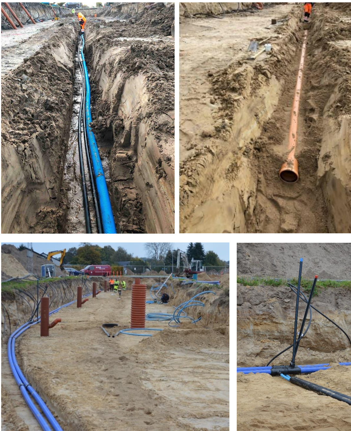
Figur 13 Billeder fra etableringsfasen i arbejdet under selve vejkassen. Øverst: Jordvarmeslange udlagt under spildevandsledningen til udnyttelse af overskudsvarme; Hovedspildevandsledningen centralt placeret under vejkassen. Nederst: udlægning af fordelingslangerne for hhv. frem- og tilbageløb i termonettet i siden, niveau under vejkassen, og nederst højre tilslutningsrør til hver enkelt bebyggelse.
