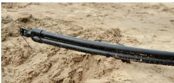
Figur 17 Jordvarmeslanger til udlægning – der blev i projektet valgt 1U jordvarmesonder med færdigsvejt bøjning, der reducerer risiko for fejl i bøjningerne ved udlægningen. Sonderne leveres i ruller og systemet trykprøves ved færdig etablering.
